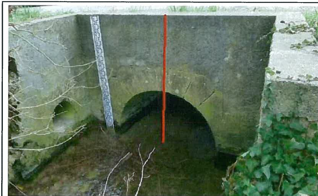
Ruisseau «le Crépé », à Crépé (pont de la D 262) : mesure du niveau en référence au bord amont du pont (ou lecture directe sur l'échelle lorsque le niveau le permet)
